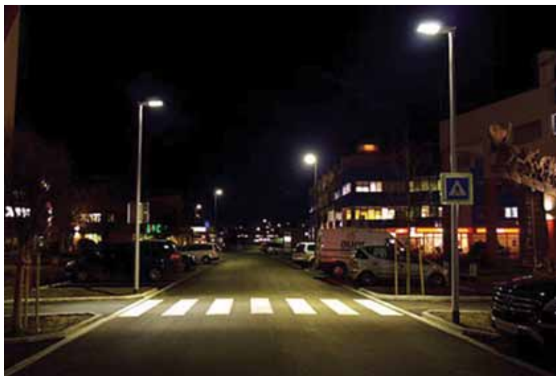
Рис. 4. Освещение пешеходного перехода с помощью проектора компании SWARCO FUTURIT
